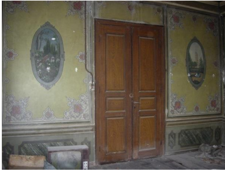
Fotoğraf 233 Restorasyon öncesi batı duvarı (Kapar, 2008)
