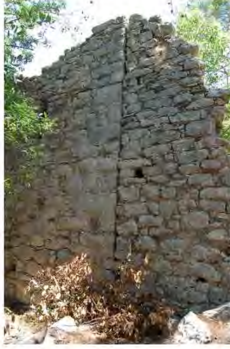
Şekil 32. Episkopeion batı cephe, M1 ve M2 duvarları arasındaki dilatasyon
