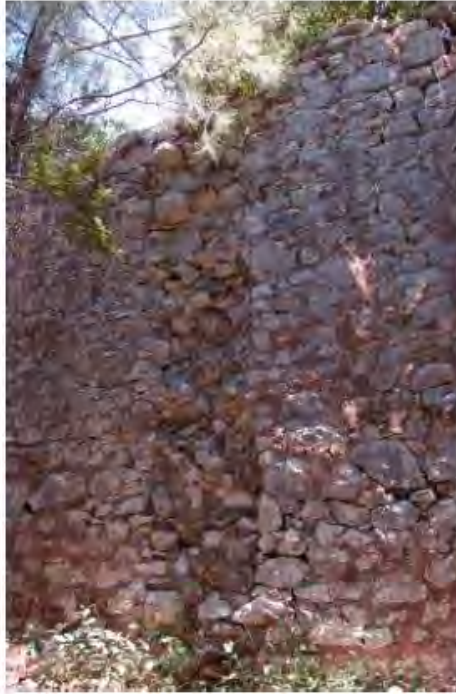
Şekil 37. Episkopeion batı cephede görülen kesilmiş duvar izlerinden doğudaki
