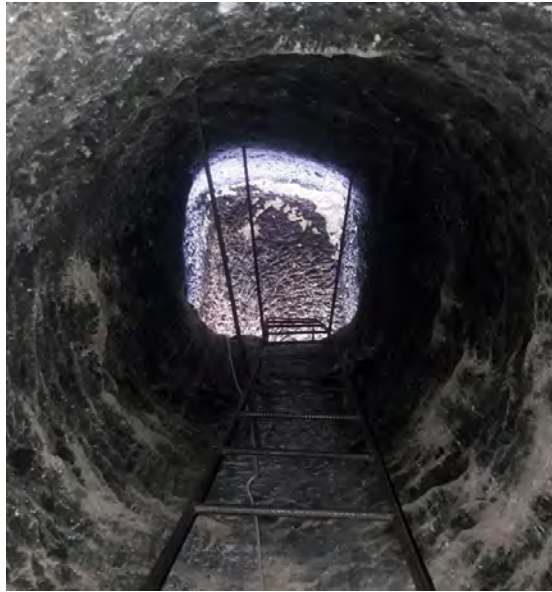
Figür 237: 4. Kat-Üstteki Aydınlatma Katı Arasındaki Baca
