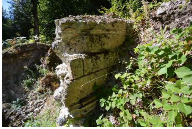
Figür 188: Kuzey Duvardaki Çökertme Yüzey
