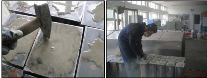
Şekil 3.26. Üst başlıkta beton-çelik etkileşim bölgesindeki boşlukların giderilmesi
