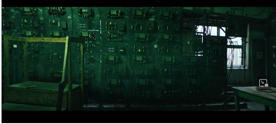
Görsel 4.24. Fabrikanın Beyni Kontrol Paneli/Fabrika/İç/Gündüz
