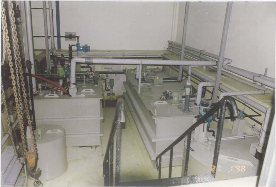
Şekil 7.11. TEI atıksu arıtma tesisi kesikli ve sürekli arıtım hatlarının genel görünümü
