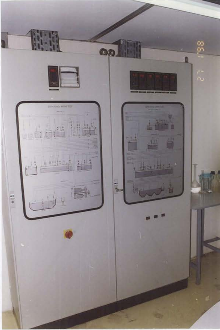
Şekil 7.13. TEI atıksu arıtma tesisine ait otomatik kontrol ünitesi
