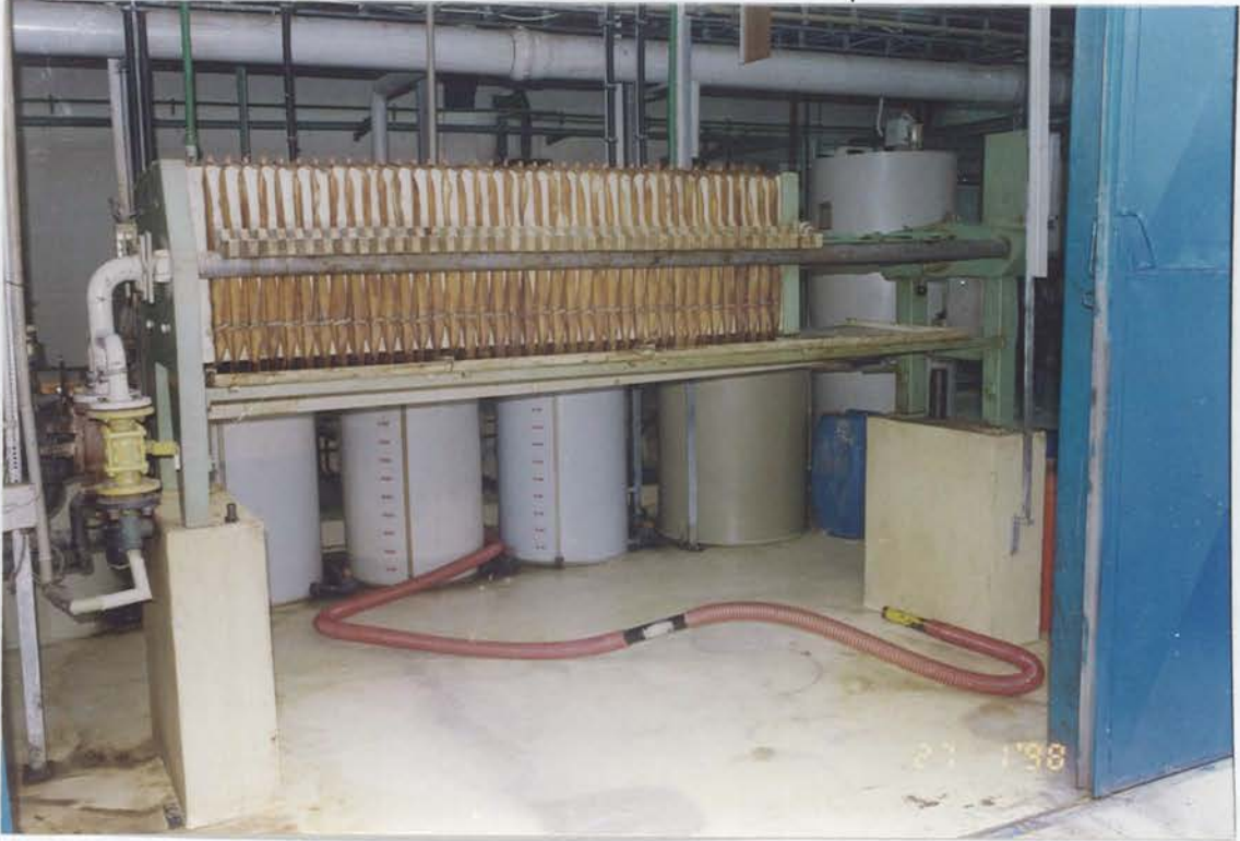
Şekil 7.17. TEI' de arıtma çamurunun suyunu almak üzere kullanılan filterpres
