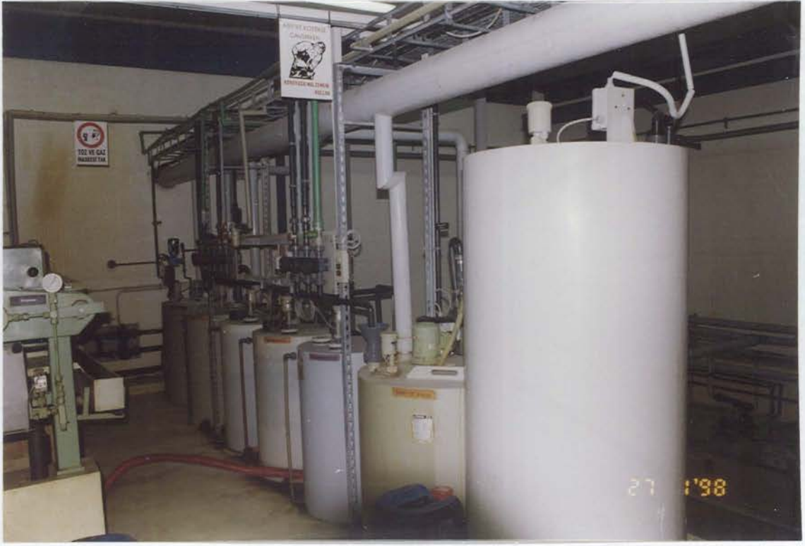
Şekil 7.16. TEI atıksu arıtma tesisi kimyasal depolama tanklarının görünümü
