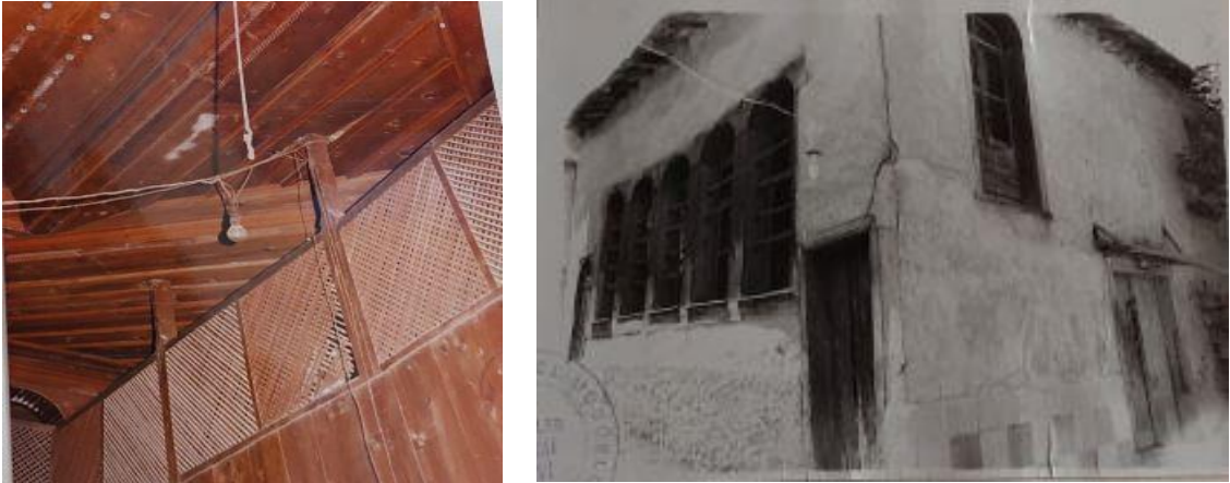
Görsel 55. Mesudiye Camii Mahfil Bozulan Ahşap Kısımları ve Dış Cephe 1989(Kütahya Kültür ve Tabiat Varlıklarını Koruma Bölge Kurulu Müdürlüğü Arşivi)
