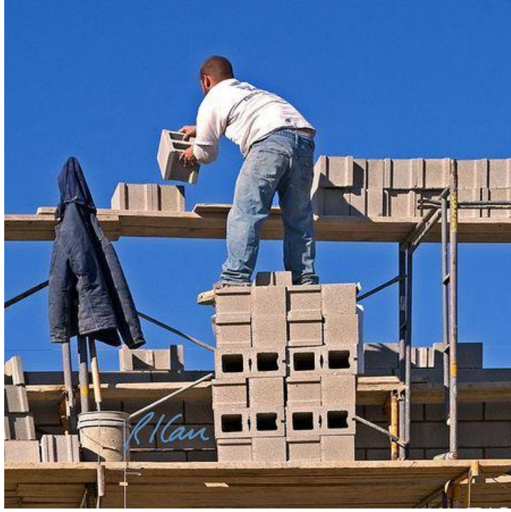
Şekil 3.3. Güvensiz davranışlar - Yığılma yapı güvenliği, düşme tehlikesi
