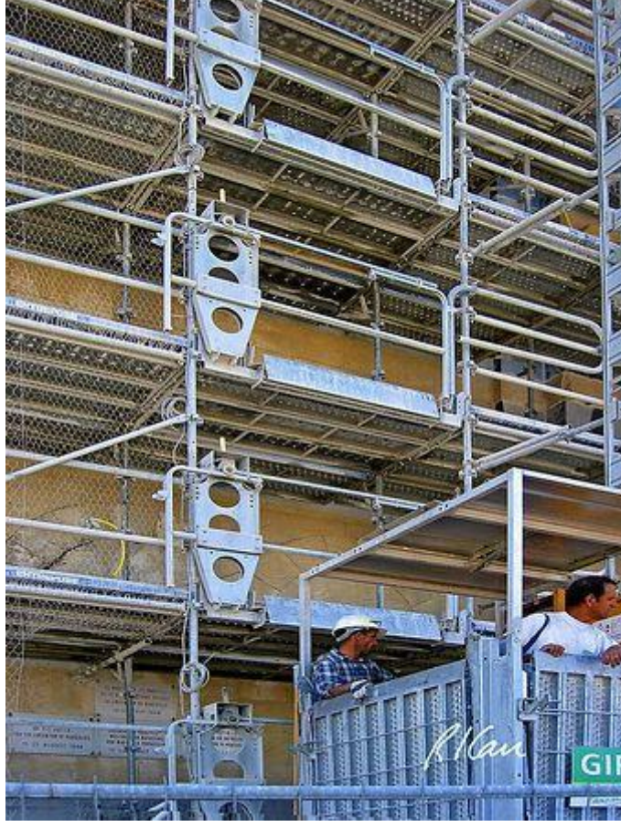
Şekil 3.5. Güvensiz davranışlar - Güvencübir inşaat iskelesi
