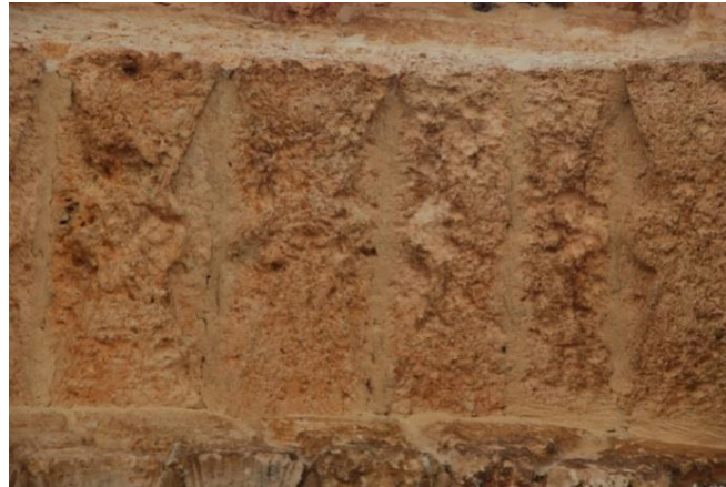
Görsel 73. Sivri kemerin altındaki deforme olmuş motiflerin bazıları
