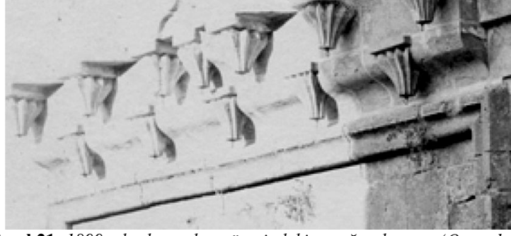
Görsel 21. 1899 yılında taç kapı üzerindeki saçağın durumu (Oppenheim) ( http://arachne.uni-koeln.de/item/marbilderoppenheim/12416 )
