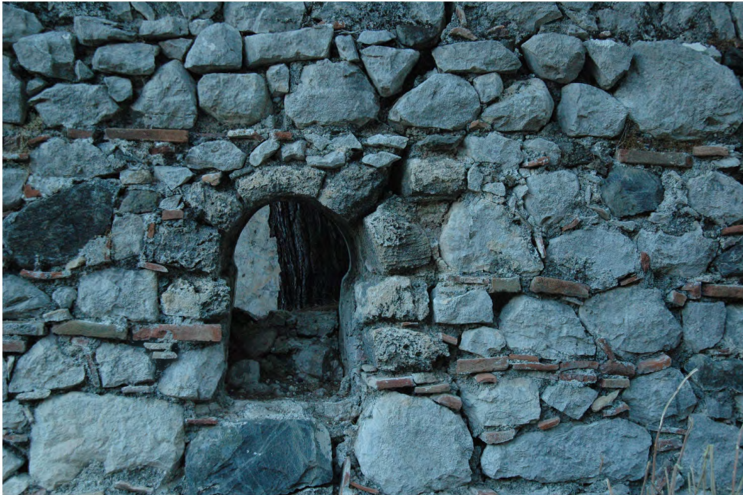
RESİM 6. Bazilika; Kuzey cephe, batı pencere
