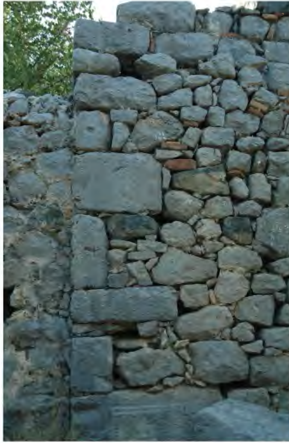
RESİM 12. Bazilika; Doğu cephe, çevre duvarı ve naosun birleşme noktası
