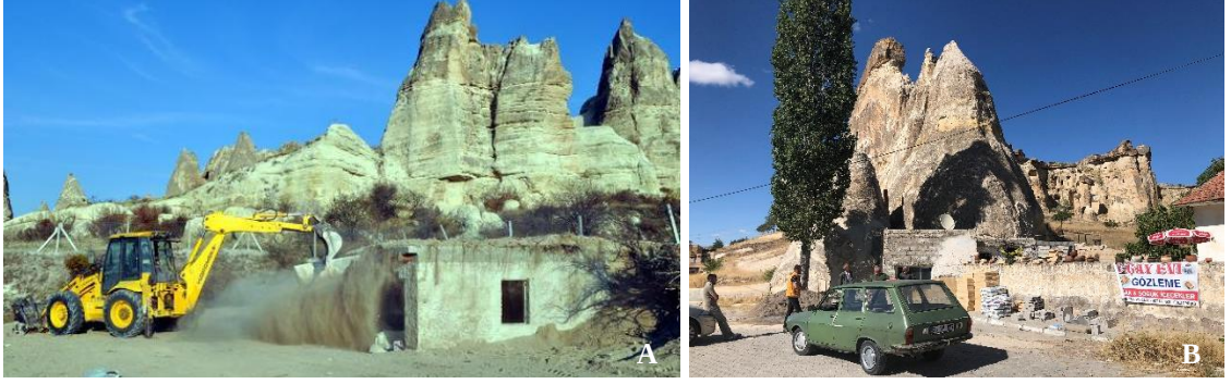
Görsel 3. 17. Kaçak yapılaşma (A.Zemi vadisindeki yıkım (http-89), B. Cavuşin)
