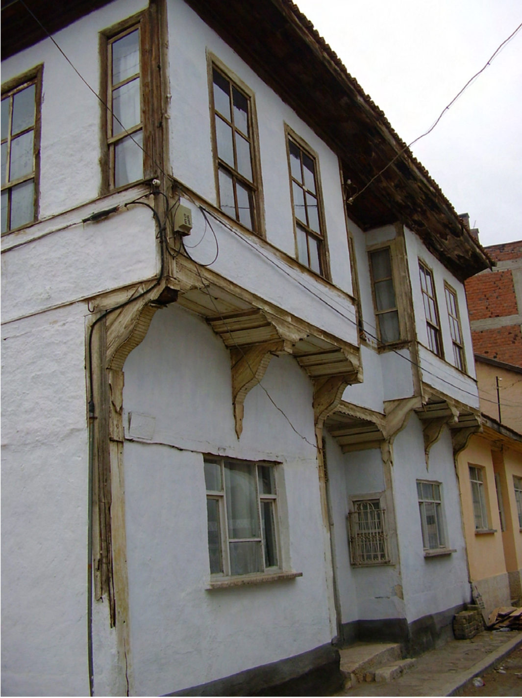
Resim 14 – Pazaryeri – Doğanlar Mahallesi Kısa Sokak No : 10
