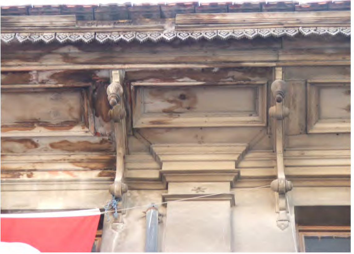
Resim 46: Bozüyük- Kasımpaşa Mah. Hamam Sok. No: 2
