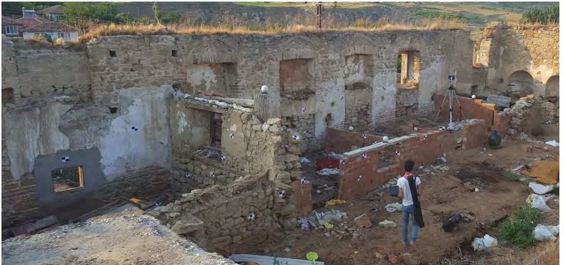
Fotođraf 246: řark y Tepek y Mahallesi Aziz Georgios Rum Kilisesi Muhdes Yapı İ inde Kalan  zg n Ahřap S tun Kalıntısı (2016))(Taksim Yapı)
