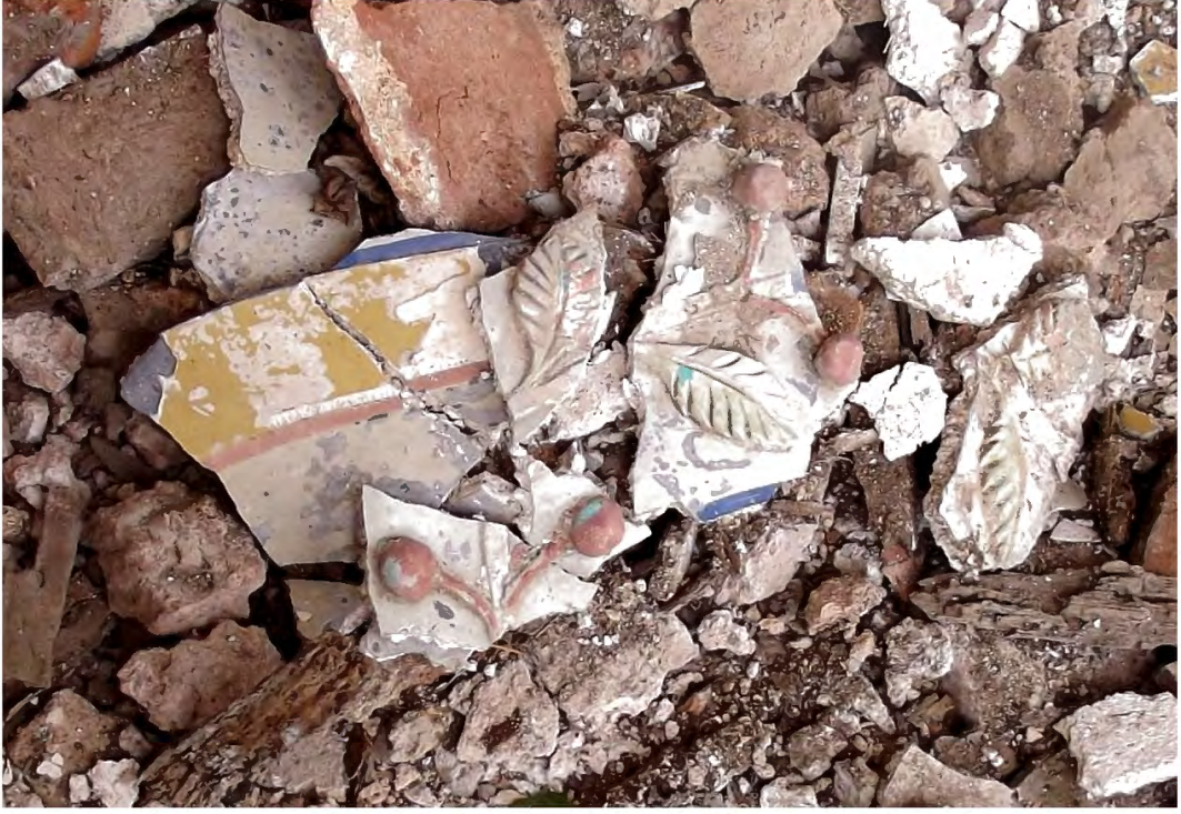
Fotoğraf 226: Tekirdağ Malkara Surp Toros Ermeni Kilisesi Güney Duvarından Yere Düşen Alçı Süslemeler (Taksim Yapı)
