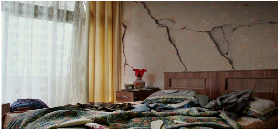
Görsel 4.50. Açılış Görseli: Duvarları Çatlayan Dağınık Yatak Odası
