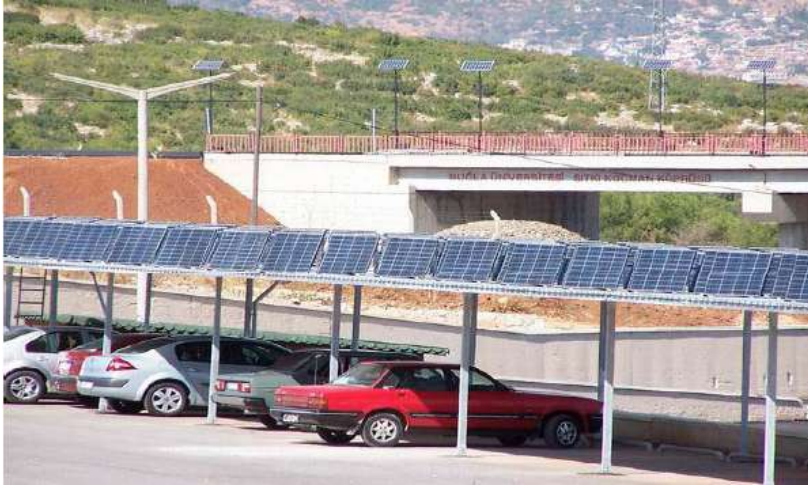
Şekil 4.9. Muğla Üniversitesi otopark çatısında fotovoltaiik sistem [48]
