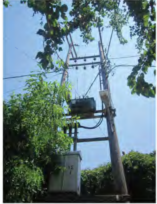
Görsel 296. Elektrik direkleri, Yunanistan
