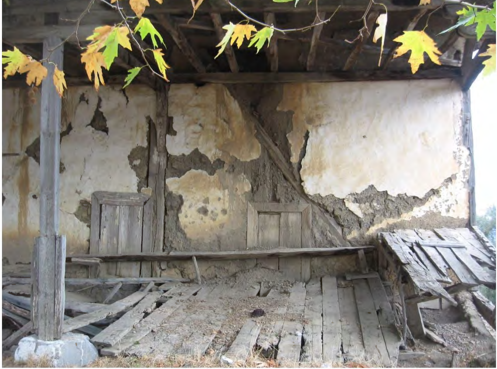
Fot. 146 Amasya merkez ilçe Kızılkışlacık Köyü Camii batı cephesinde sonradan kapatılan pencere açıklıkları
