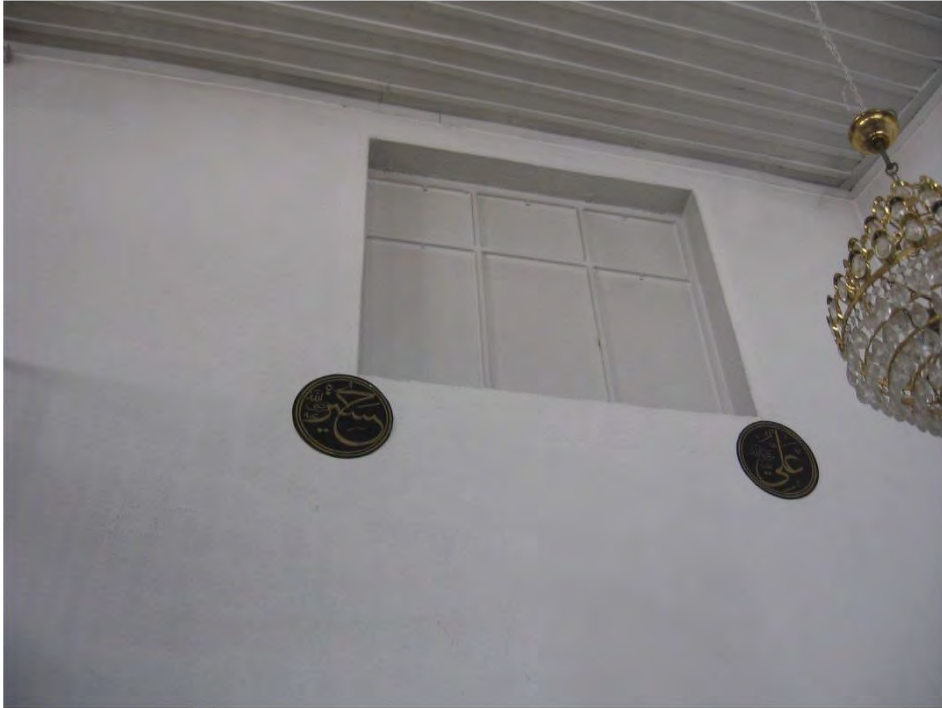
Fot. 465 Amasya merkez Köprübaşı Camii günümüzdeki yapının hariminden doğu duvarındaki sonradan kapatılan pencere açıklığı
