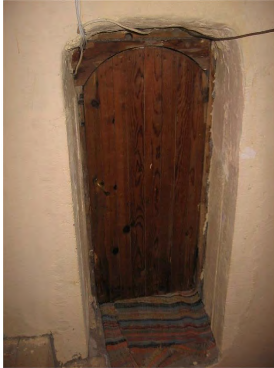
Fot. 212 Amasya merkez ilçe Mahmatlar Köyü Camii orijinal minareye çıkışı sağlayan kapı
