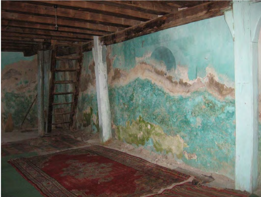
Fot. 114 Amasya merkez il e Kalek y Camii kuzey duvarının batı k şesindeki bug n var olmayan bezemeden kalıntı
