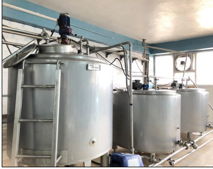
Görsel 3.5. Soğutma tankları
