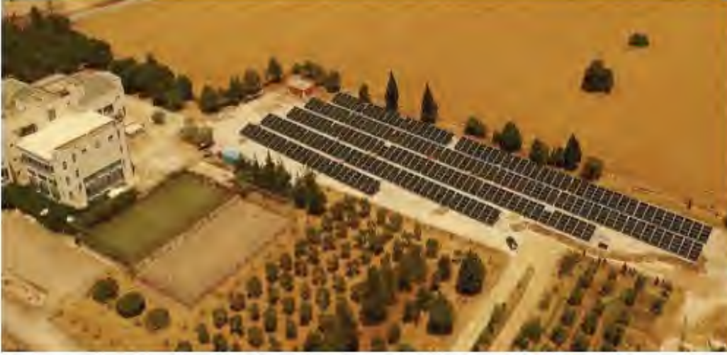
Görsel 4.5. Dokuz Eylül Üniversitesi Torbalı Kampüsü Fotovoltaik Panelleri
