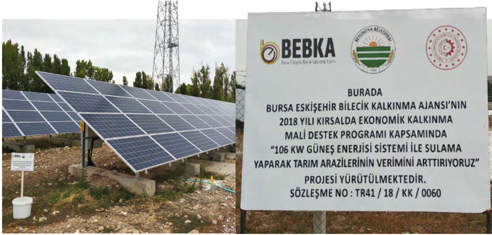
Görsel 4.8. Eskişehir Beylikova Belediyesi GES
