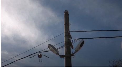
Görsel 4.31. Elektrik telleri
