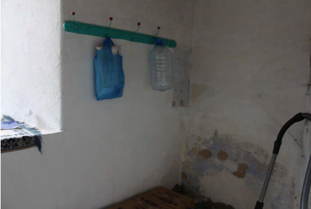
Fotoğraf No:12 Bodur Cami Cephe Üzerinde Rutubet İzleri (2017) (Sinan ÜNAL)
