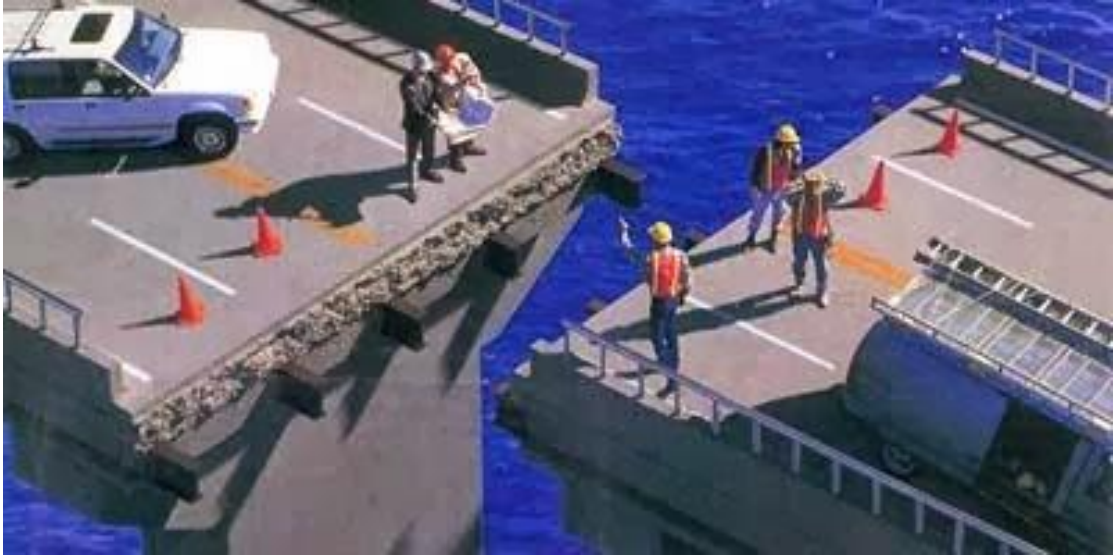
Görsel 2.1. İnşaat yapım işi hatası (http-1)
