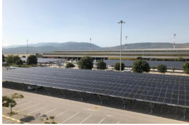
Şekil 2.14. Milas Bodrum Havaalanı güneş enerji panelleri (Solarist, 2023)
