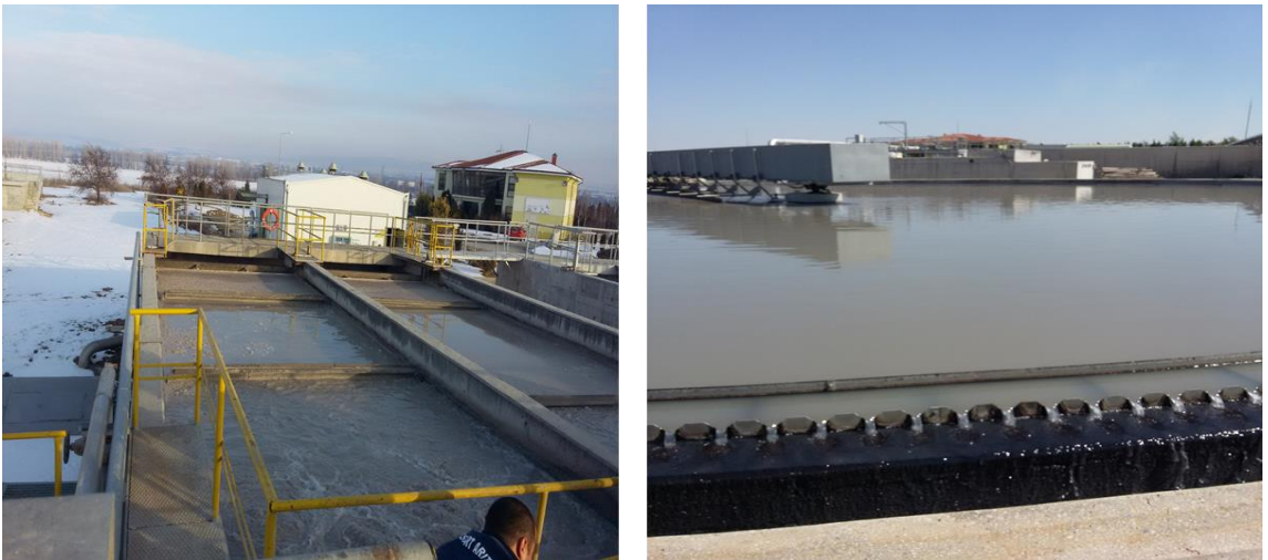
Şekil 2.8. Endüstriyel Atık Su Arıtma Tesisi kum tutucu ve ön çökeltim ünitesi
