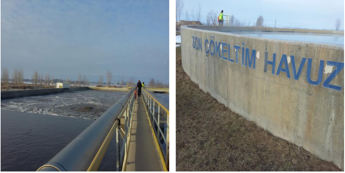
Şekil 2.9. Endüstriyel Atık Su Arıtma Tesisi havalandırma ve son çökeltim ünitesi
