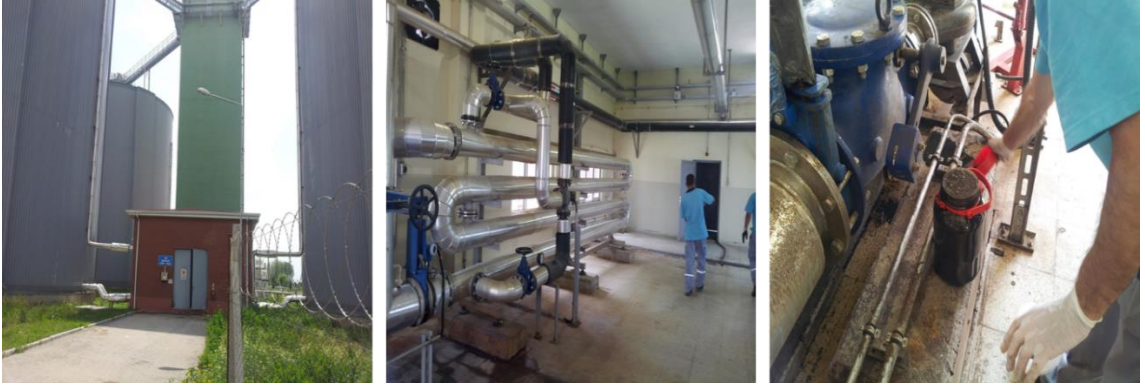
Şekil 2.7. Belediye Atık Su Arıtma Tesisi anaerobik çürütücü
