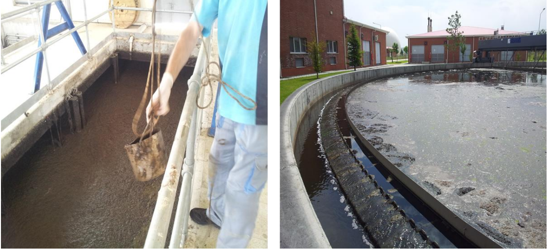
Şekil 2.6. Belediye Atık Su Arıtma Tesisi geri devir çamur ve son çökeltim ünitesi
