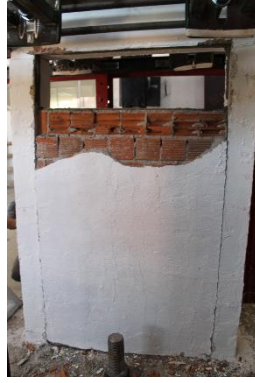
(c) Son çevrimdeki duvar hasarı
