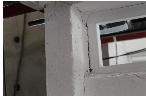
(b) Birleşim bölgesindeki ilk çatlak
