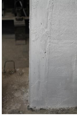
(a) Duvarda gözlenen ayrılma
