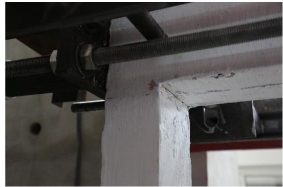
(b) Birleşim bölgesindeki ilk çatlak
