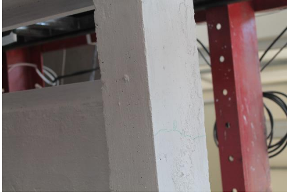
(a) Kolondaki ilk eğilme çatlak
