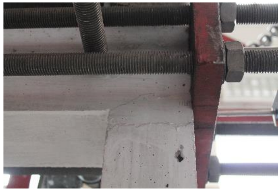
Görsel 4.3. IE01 Birleşim bölgesindeki ilk çatlak
