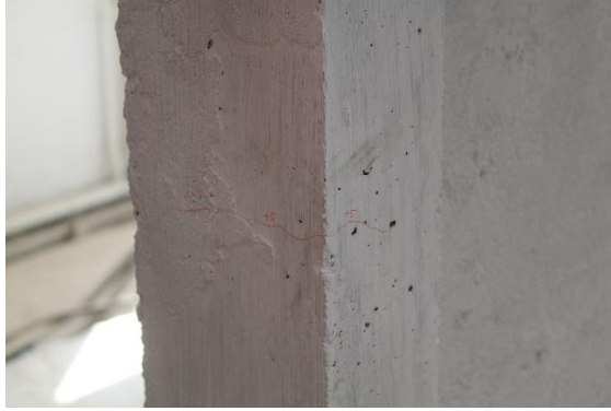
(a) Kolondaki ilk eğilme çatlaklığı
