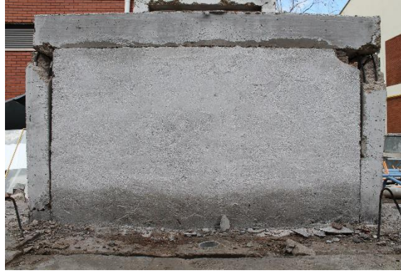
(c) Son çevrimdeki duvar hasarı
