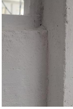
(a) Duvarda gözlenen ayrılma
