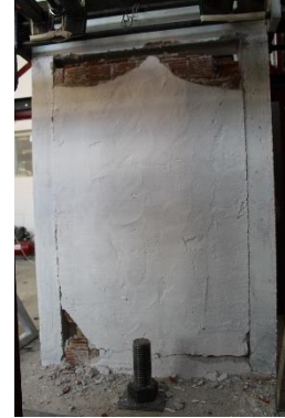
(d) Son çevrimdeki duvar hasarı
