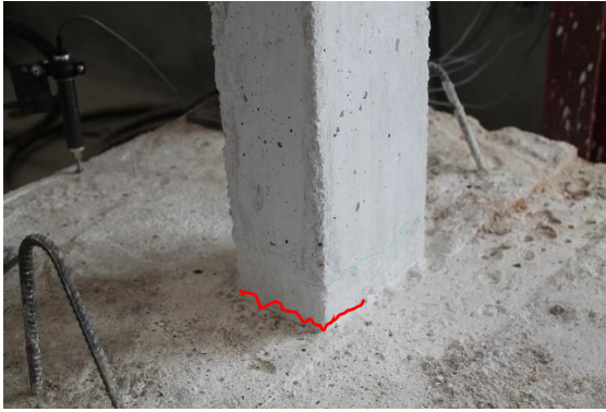
(a) Kolondaki ilk eğilme çatlağı
