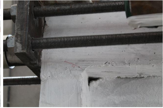
(b) Birleşim bölgesindeki ilk çatlak
