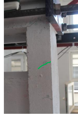
(b) Kolondaki ilk kesme çatlak
