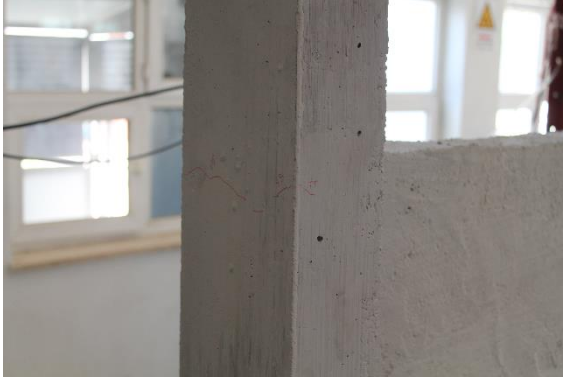
(a) Kolondaki ilk eğilme çatlak
