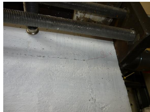
(b) Birleşim bölgesindeki ilk çatlak
