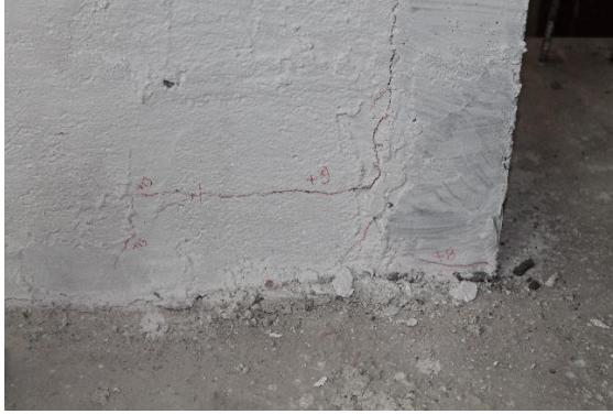
(a) Kolondaki ilk eğilme çatlağı
