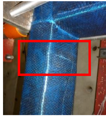
(b) CFRP katmanlarının şişmesi
