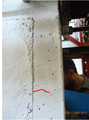
(a) Kolondaki ilk eğilme çatlak
