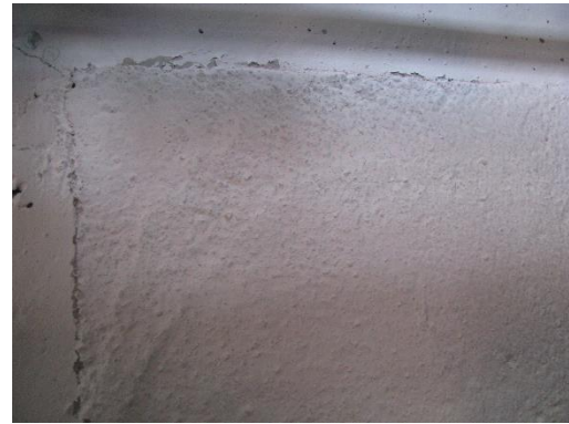
(b) Birleşim bölgesindeki ilk çatlak
