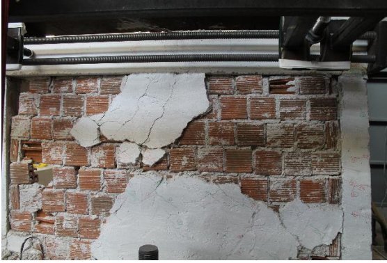
(c) Yıkılmadan önceki duvar hasarı
