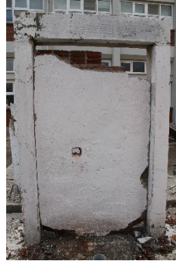
(c) Son çevrimdeki duvar hasarı
