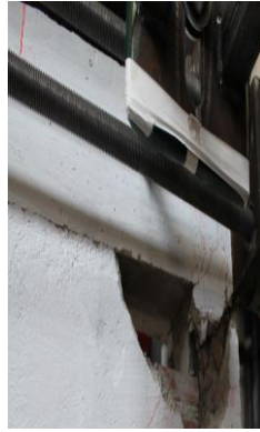
(a) Kirişteki ilk eğilme çatlağı
