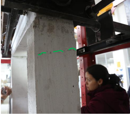
(a) Kolondaki ilk eğilme çatlağı
