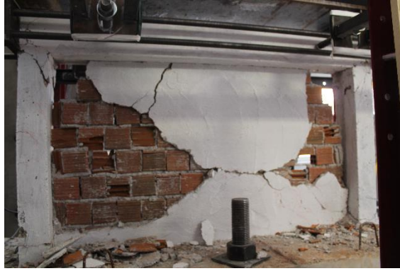
(c) Son çevrimdeki duvar hasarı
