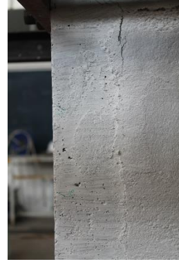
(b) Duvarda gözlenen ezilme
