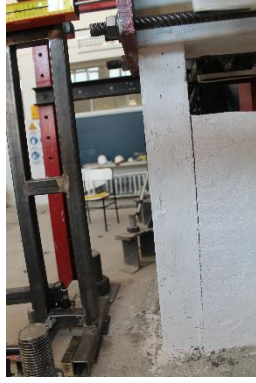
(a) Duvarda gözlenen ayrılma
