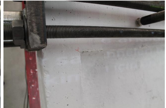
(b) Birleşim bölgesindeki ilk çatlak
