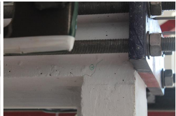
(b) Birleşim bölgesindeki ilk çatlak
