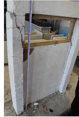
(d) Son çevrimdeki duvar hasarı
