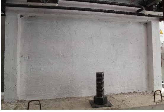
(a) Duvarda gözlenen ayrılma
